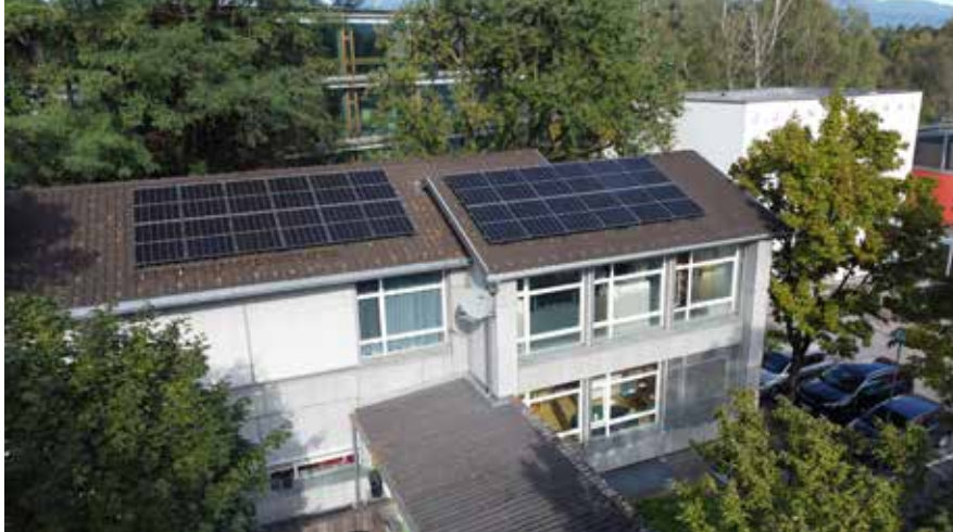
Die Photovoltaikanlage auf dem Vereinsheim leistet 10 kWp.
