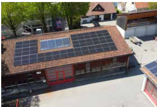
Photovoltaikanlage auf dem Dach des Bauhofs
